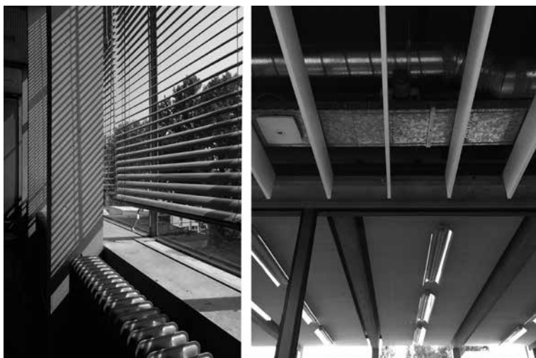
Fig. 5. La línea de instalaciones junto a la fachada (Amsterdam) y en el techo de la galería central (Arnhem). Fotografías Martínez Arroyo+Pemjean.
