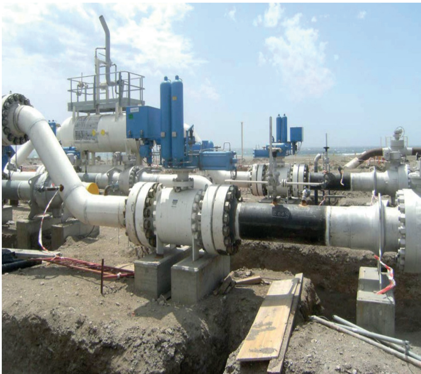
Terminal de recepción del gasoducto Medgaz en la playa El Predigal, Almería [Medgaz]
