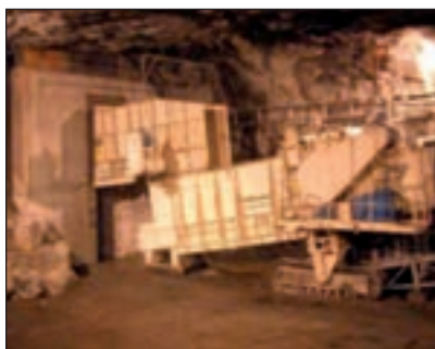
Planta de tratamiento primario compacto. Cantera de Apario.
