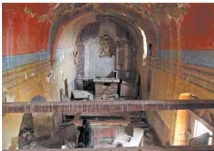
El interior de la iglesia del despoblado de Bézquiz, en la Valdorba, un edificio del románico tardío que también amenaza ruina.
